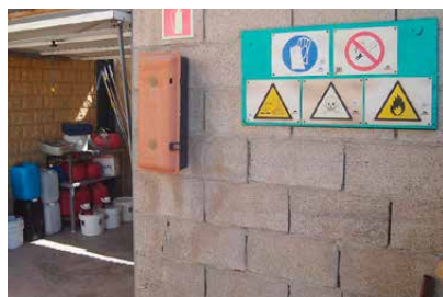
Almacén separado de vivienda y animales, debidamente señalizado y suelo impermeabilizado.
